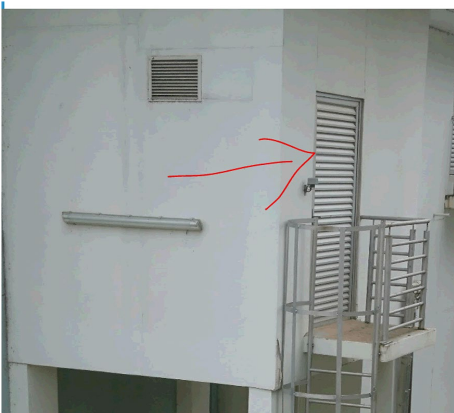
(Figura 1 ilustrativa - Porta de uma das casas de máquinas, a ser substituída)
